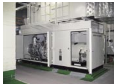
附属病院（中央設備室）ガスタービン発電機
