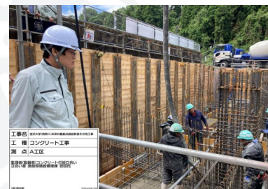
コンクリート打設の立会の様子 構造に関わる重要な立会
